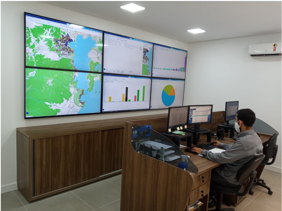
Figure 1. Imagem da sala de monitoramento do Centro de Controle Operacional da Concessão de Iluminação Pública do Município de Palhoça
