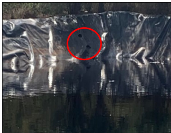
Figure 12. Danos na geomembrana da lagoa de tratamento de chorume - Fonte: Elaborado pelos autores (2021)
