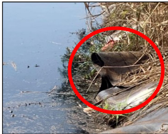
Figure 11. Danos na geomembrana da lagoa de tratamento de chorume
